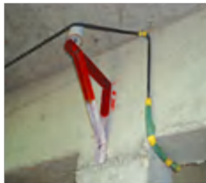
电缆架空支座
