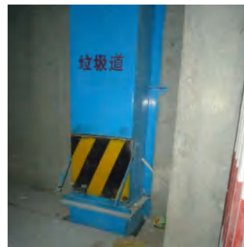
楼层建筑垃圾管道
