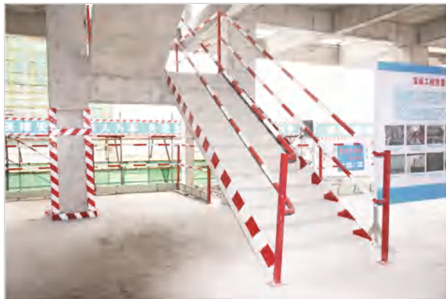
楼梯临边防护
