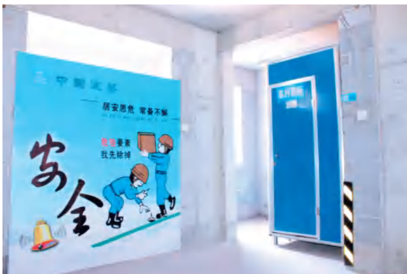
楼层临时厕所
