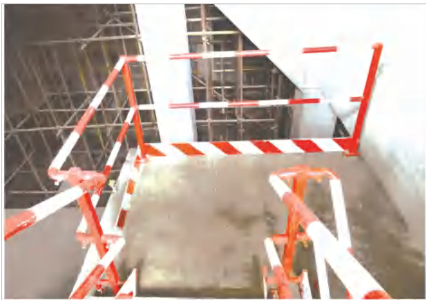
楼梯临边防护
