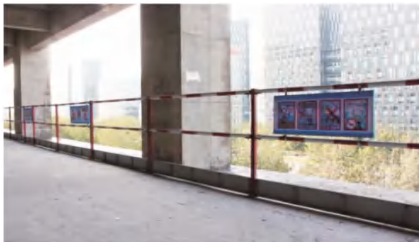
楼层临边防护
