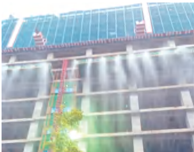
楼层自动喷淋降尘装置
