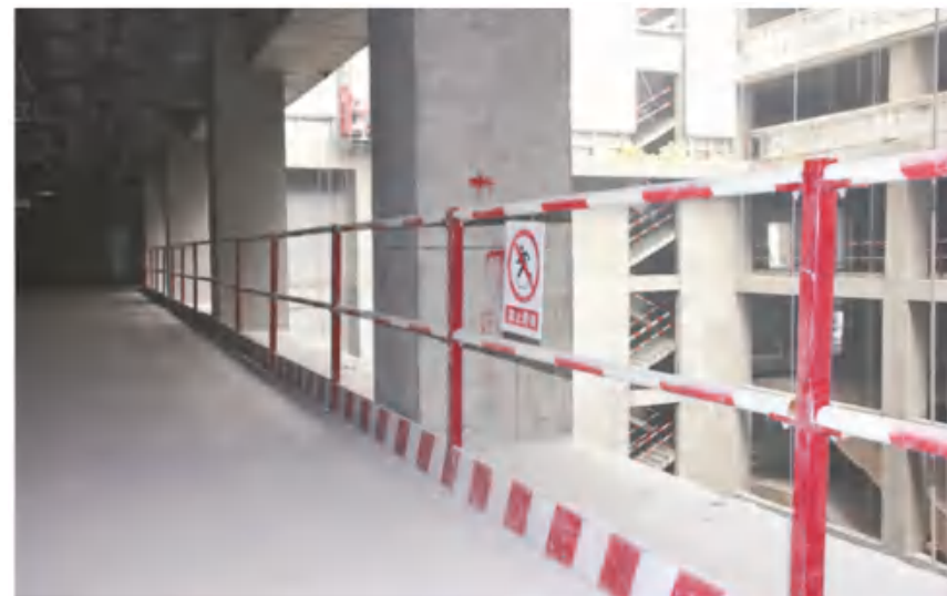
楼层临边防护
