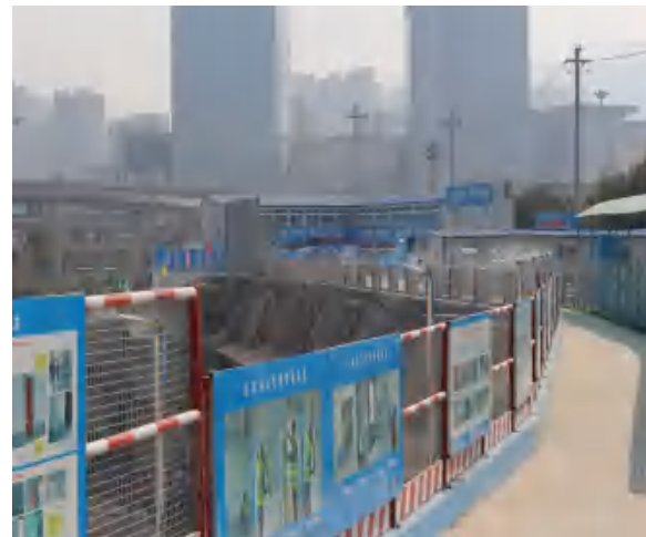
基坑周边自动喷淋降尘装置
