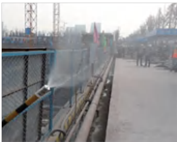
道路周边自动喷淋降尘装置
