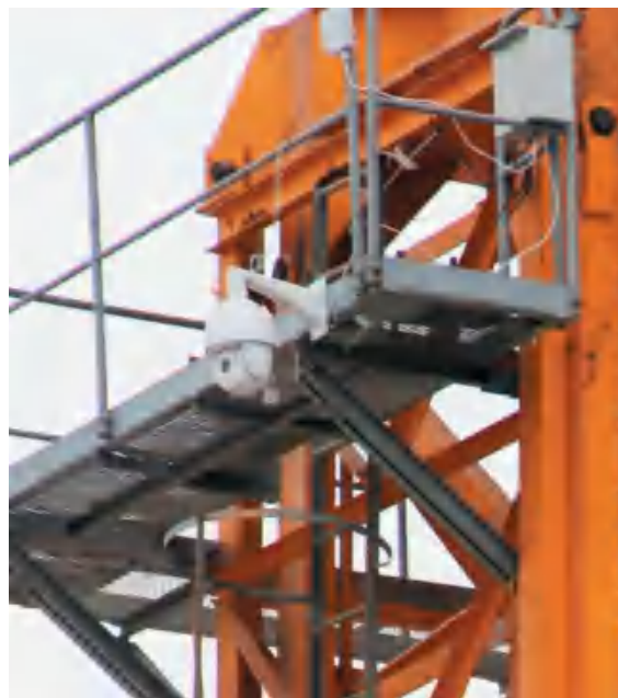
监控探头（塔机）
